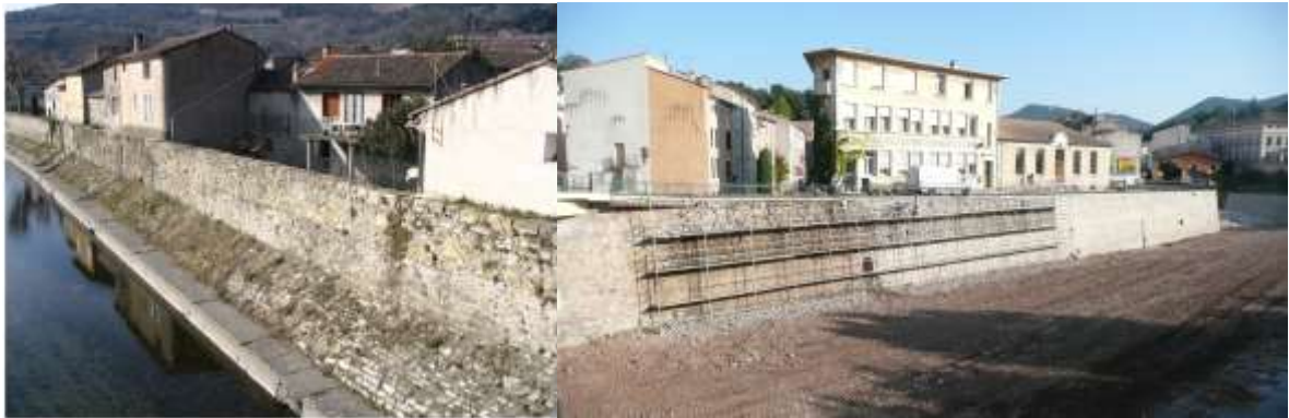
A droite, le rempart de Villemagne l'Argentière le long de la Mare avant travaux A gauche, la digue de la Poste à Bédarieux pendant les travaux de confortement
