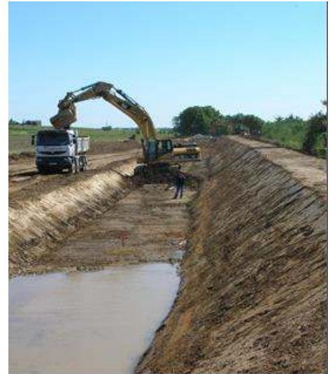
A gauche mise en place des batardeaux de la digue de Sérignan en mars 2022 et à droite : partie terminale du Canal de Crète à Valras et sa contre digue
