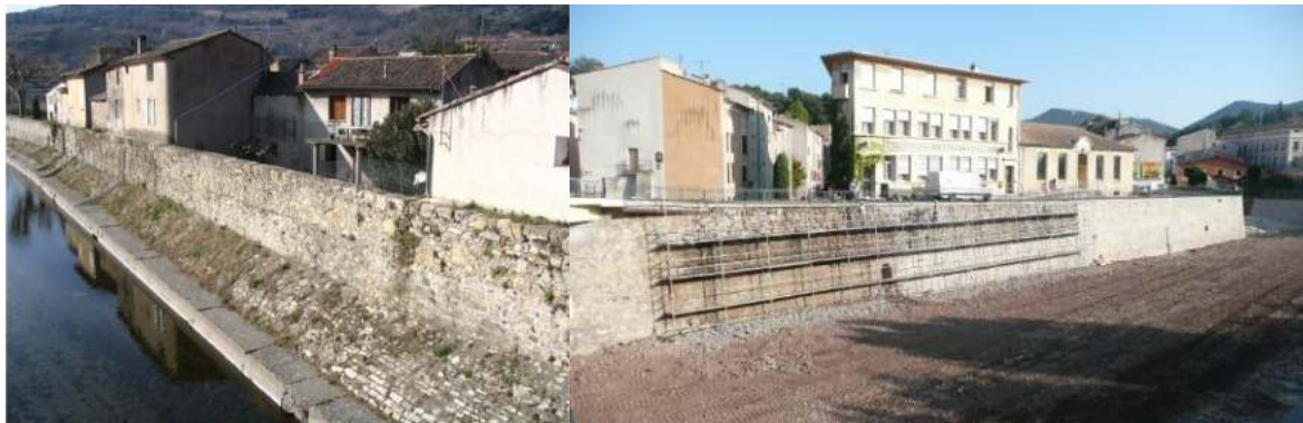
A droite, le rempart de Villemagne l'Argentière le long de la Mare avant travaux
